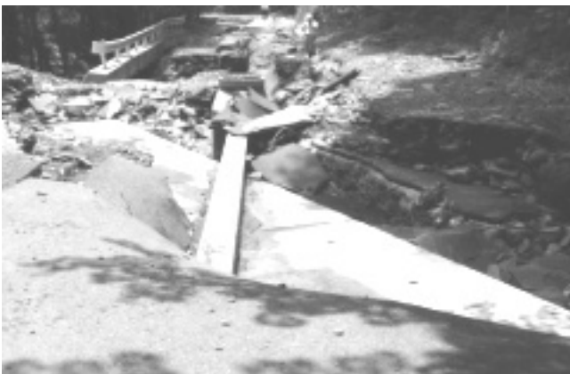
土石流が橋を崩壊させ交通を遮断させてしまった奈良の大倉地区の惨状
